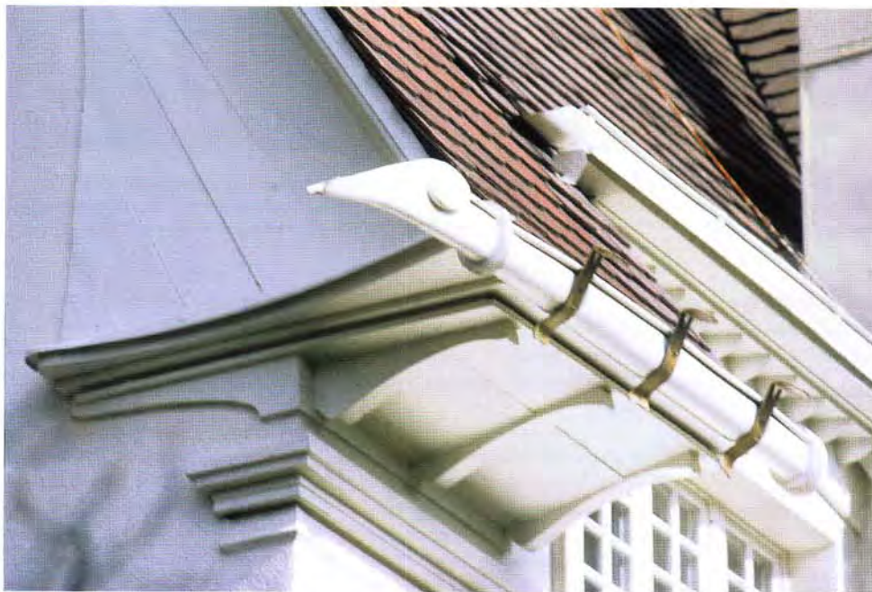
Simsdetail an einer instand gesetzten Jugendstil-Villa auf der Mathildenhöhe in Darmstadt. Die besonders geformten Rinnenspeier, schmiedeeiserne Rinnenhaken und die Weiterführung der Untersicht des Dachüberstandes in den Giebel vereinen sich zum Gesamtkunstwerk.
